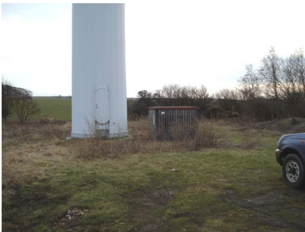
Figur 5-1 Vindmølle og transformer (foto: Steen Jensen, SEAS-NVE)
